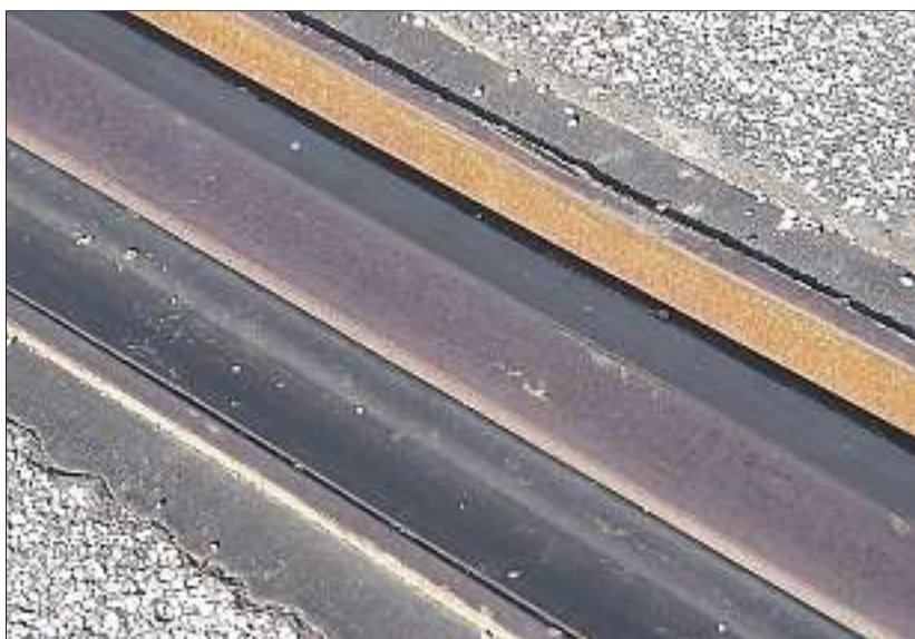
Eine moderne Trambahn ist ein lärmarmes Verkehrsmittel: Die Schienen werden in Gummipolstern gelagert (hier links des Schienenkopfes und im Fuß der Rille zu sehen)
